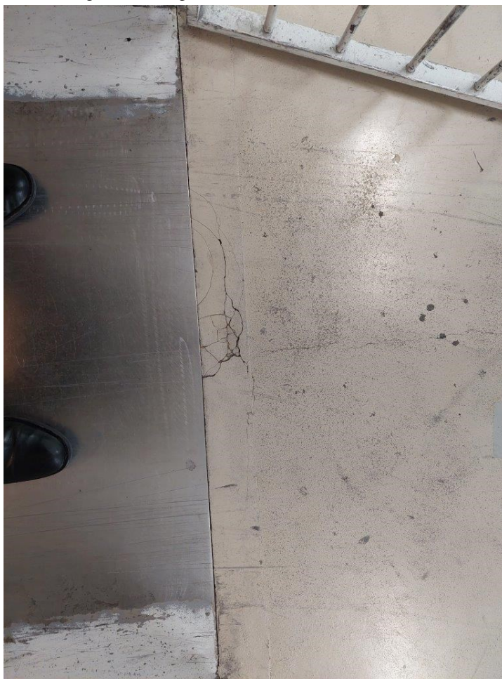
poškození u prahu dveří do trezoru 1S814
