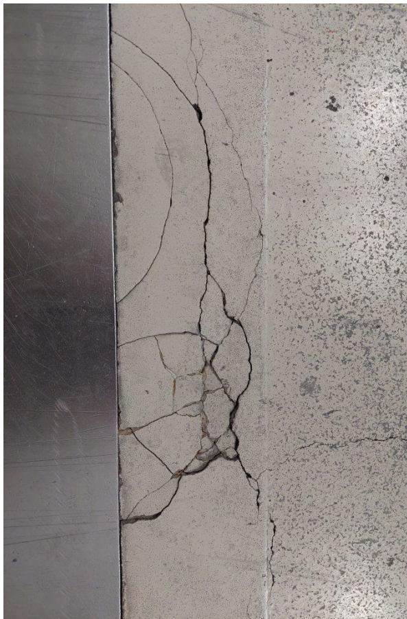
poškození podlahy u prahu dveří 1S814
