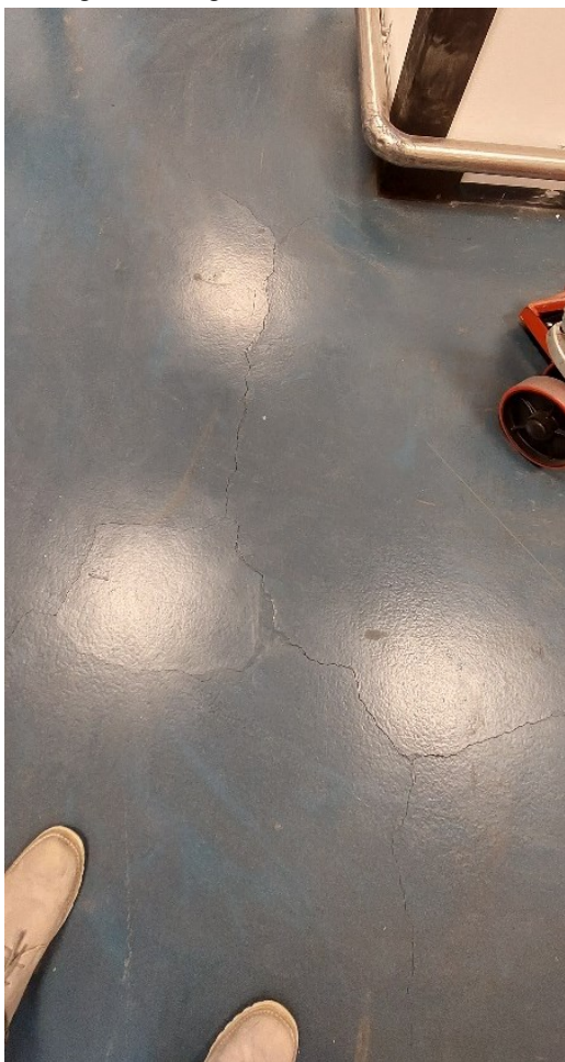
poškozená podlaha v 3S809
