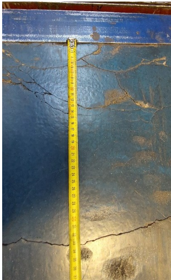
poškození podlahy u prahu dveří do výtahu 3S809
